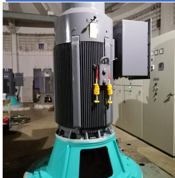
งานตรวจสอบและเช็คค่าพารามิเตอร์การทำงานของเครื่อง
